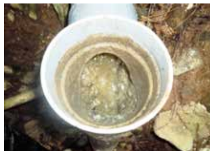
Figura 3. Estruvita en tuberías. (VIOGAZ, 2011).
