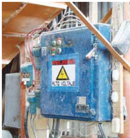
Figura 3. Señalización de áreas peligrosas.
