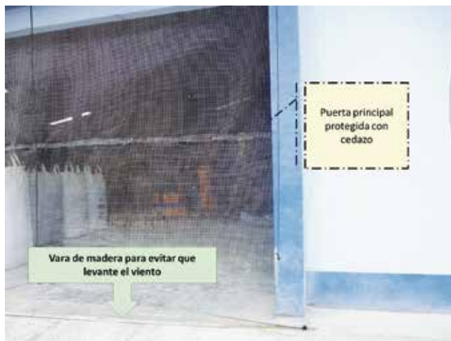
Figura 1. Acondicionamiento de puerta con cedazo para evitar la entrada de aves y roedores.
